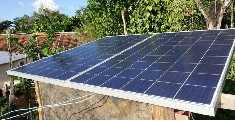
Solarmodule produzieren kostenlosen Strom für die Bewässerungspumpe.
