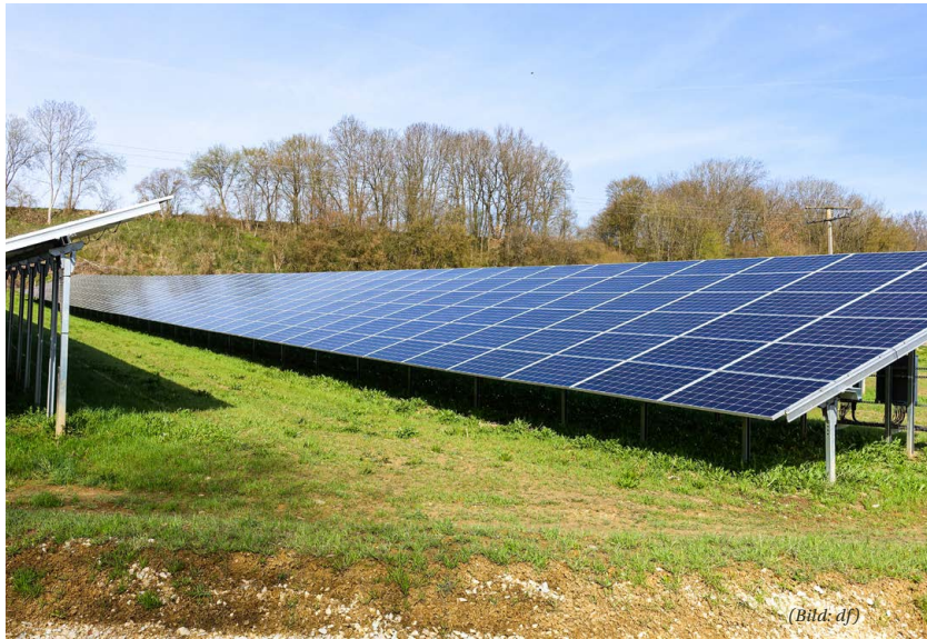
Die Zukunft hat bereits begonnen, zumindest was die Erzeugung von sauberer Energie betrifft: Der Solarpark Zwielfaltendorf in Baden-Württemberg produziert seit 2017 auf 7 ha Fläche Strom für 1670 Haushalte.
